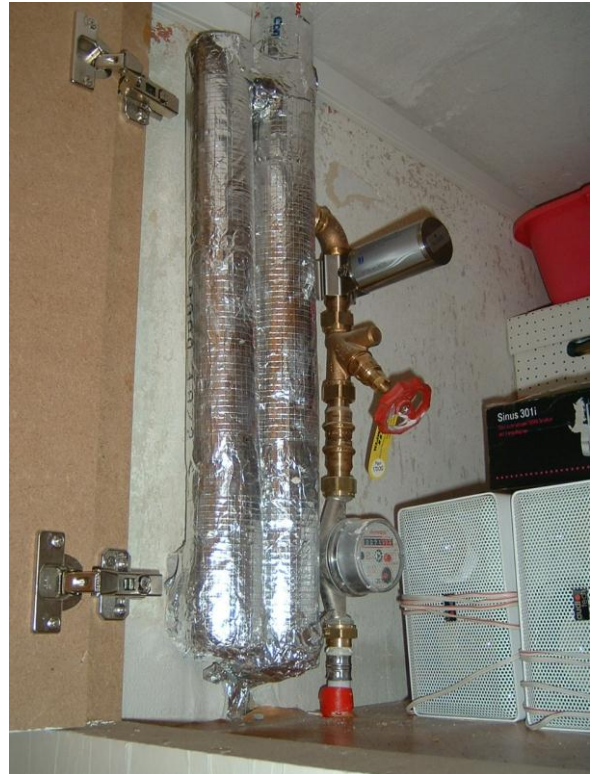
AquaKat-M im abgehängten Deckenbereich oberhalb der Dusche i. d. Warmwasserverteilung
