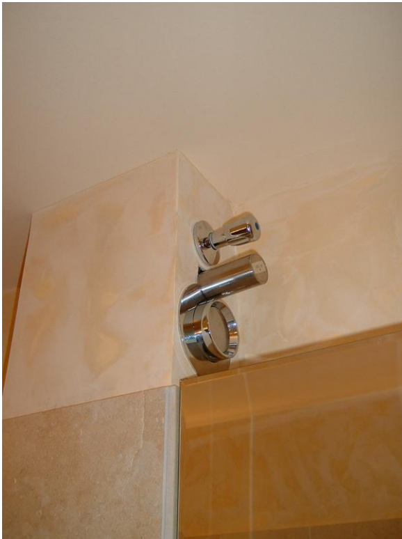
AquaKat-M im Sanitärschacht untehalb des UP-Absperrventils In der Kaltwasserverteilung
